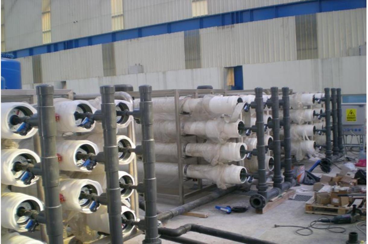
PVC ve PE 100 Saf Su Boru Hatları İři
