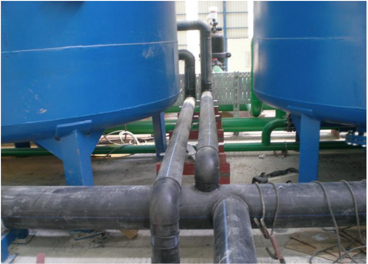
Kum Filtre Tankları Borulama İŖi
